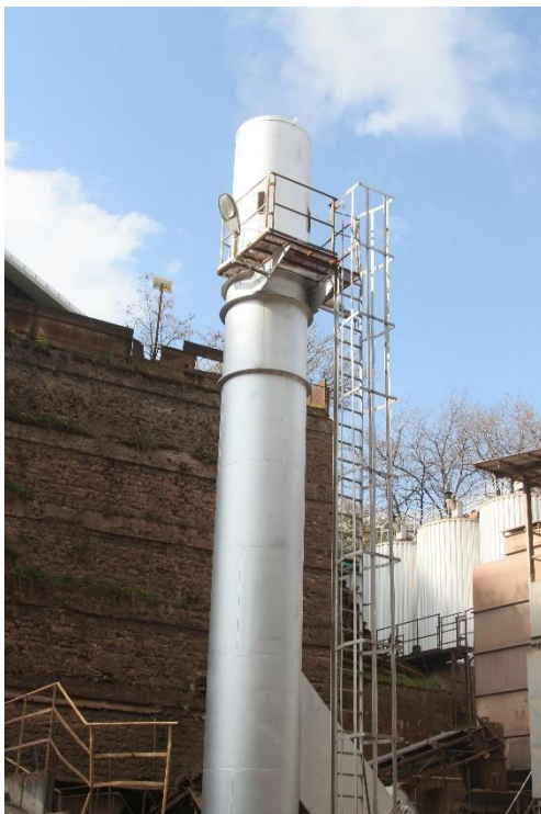
Abbildung 28: Kamin der Anlage
