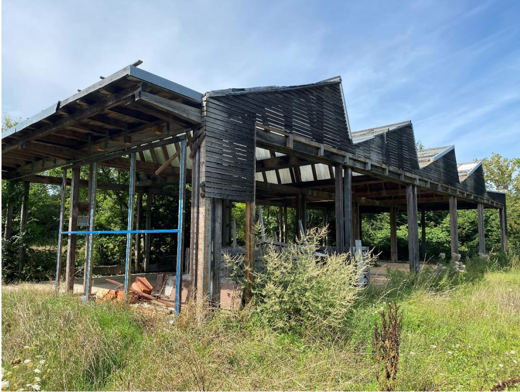
Abbildung 4: Verfallenes Gewächshaus im Norden des UG
